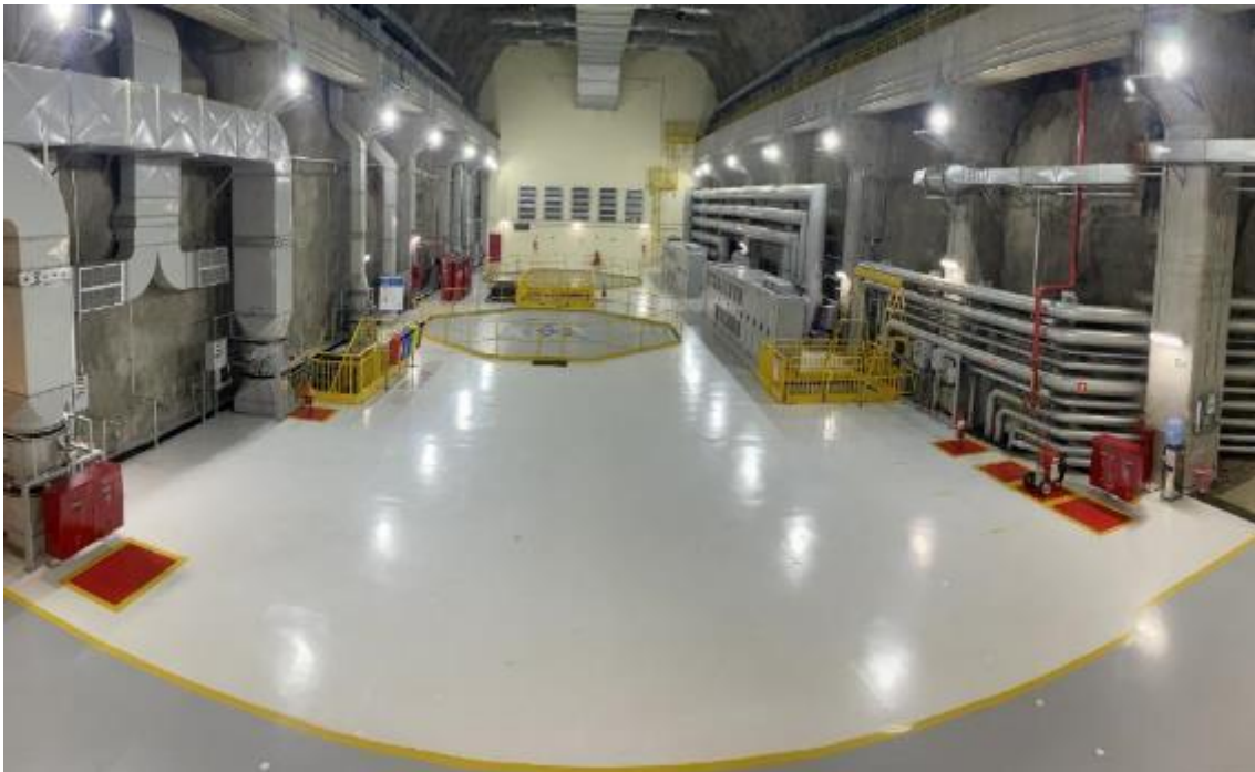
Foto 2 - Vista Interna da Casa de Força
