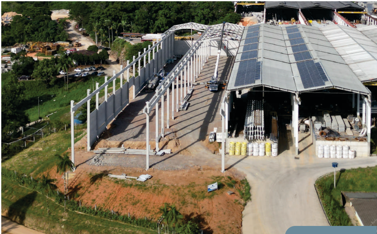
Imagem das placas fotovoltaicas instaladas no parque fabril, junto ampliação dos PM8 e PM9, dezembro 2023.
