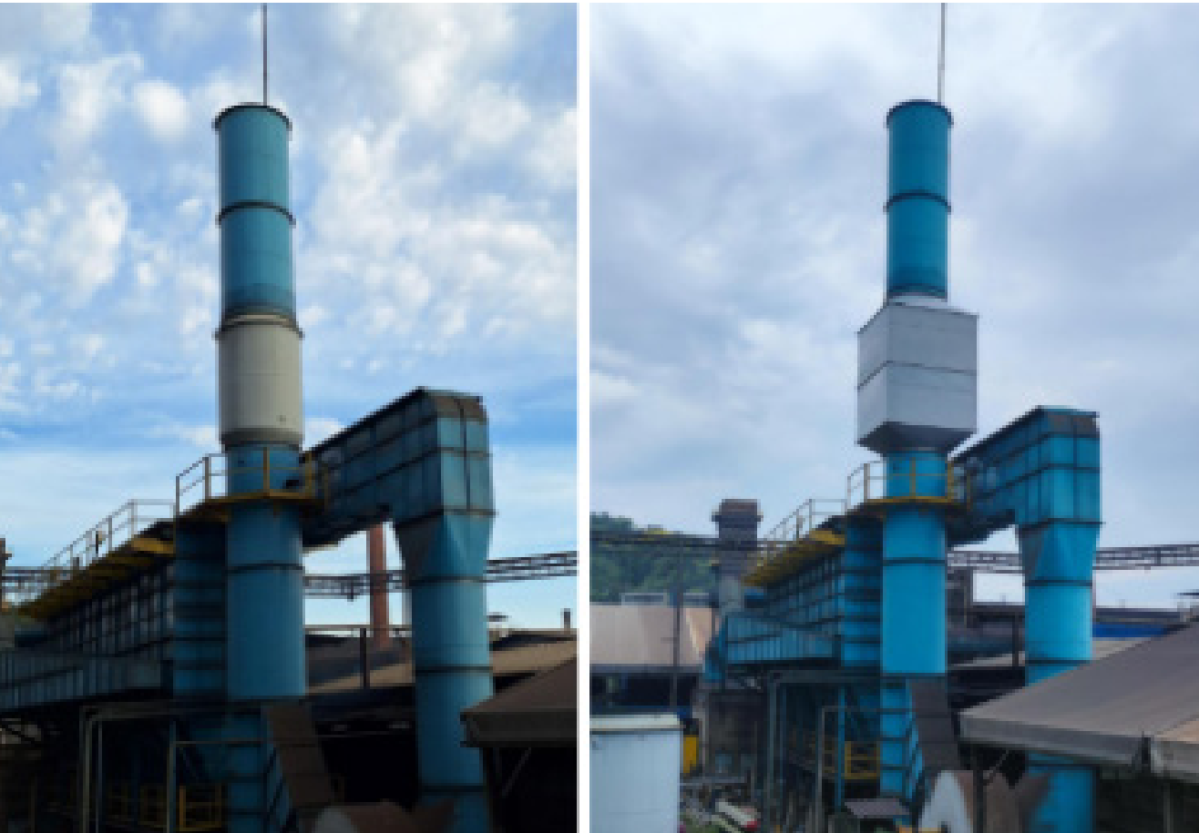
Silenciador de ruído da chaminé
