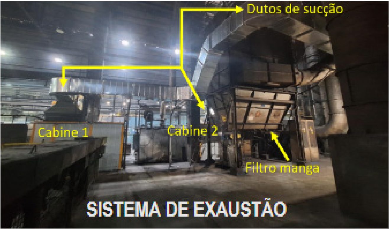
Sistema de exaustão
